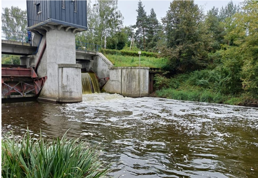
Fot. I.10. Napływ wody z sekcji IV przez wrota jazu w Pławniowicach w sytuacjach awaryjnych (fot. kpr. P. Samojednik, 25.08.2024 r.).
