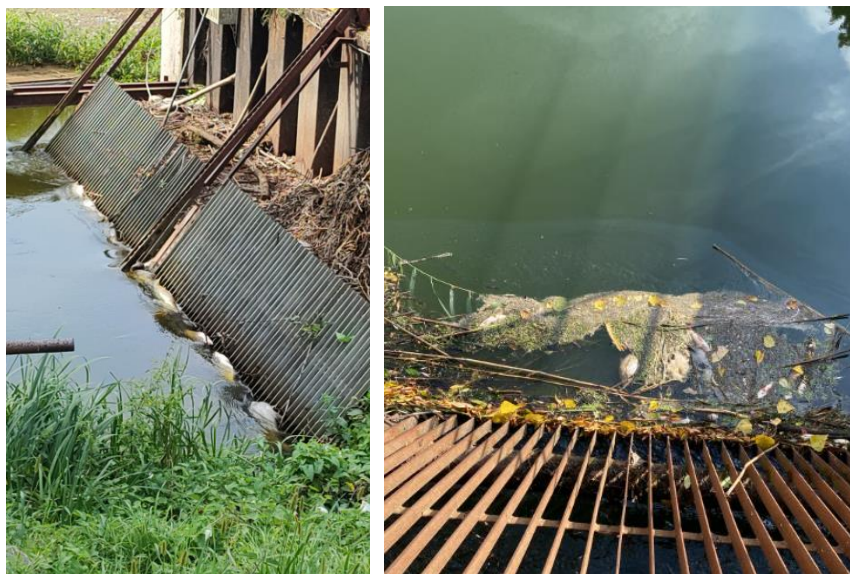
Fot. I.17. Woda górna MEW – napływ na elektrownię wodną; a) widoczne pojedyncze śnięte ryby (15.08.2024 r.); b) śnięte ryby oraz film tłuszczowy (18.08.2024 r.); (fot. Ł. Weber).
