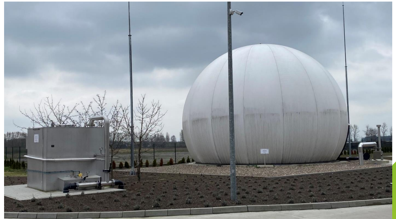
Zbiornik biogazu przy biogazowni w na terenie Przedsiębiorstwa Wodociągów i Kanalizacji Sp. z o.o. w Jarocinie
