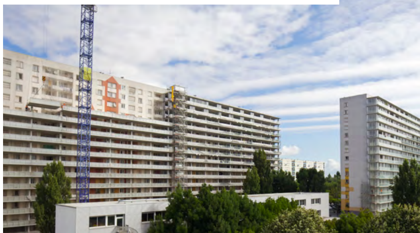
2. Przebudowa polegała na dostawieniu do istniejącej ściany zewnętrznej nowej konstrukcji, składającej się z prefabrykowanych elementów betonowych, osadzonej na własnym fundamencie.
