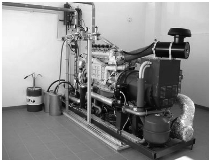
Rys. 4. Generator do wytwarzania energii z biogazu [www.ilawskiewodociagi.pl]
